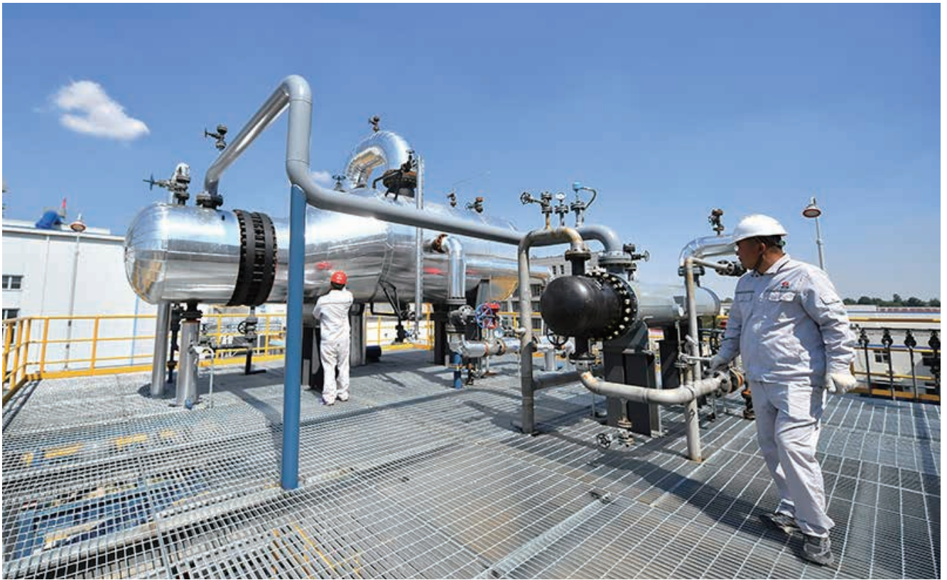
陕西省延长石油榆林煤化公司碳捕集设施，陕西榆林（照片来源：延长石油）
