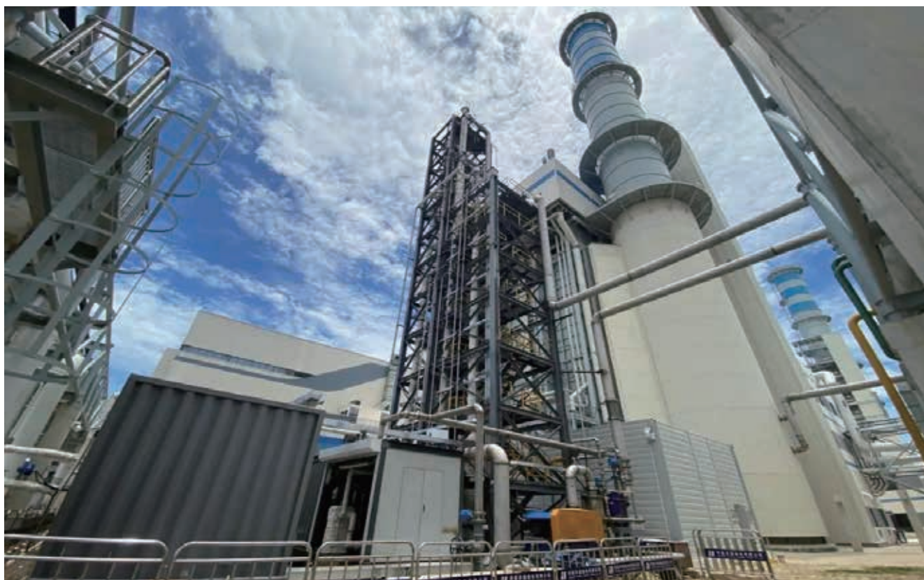
华能洋浦燃气电厂碳捕集示范项目（年捕获量 2 千吨），海南儋州（照片来源：中国华能）
